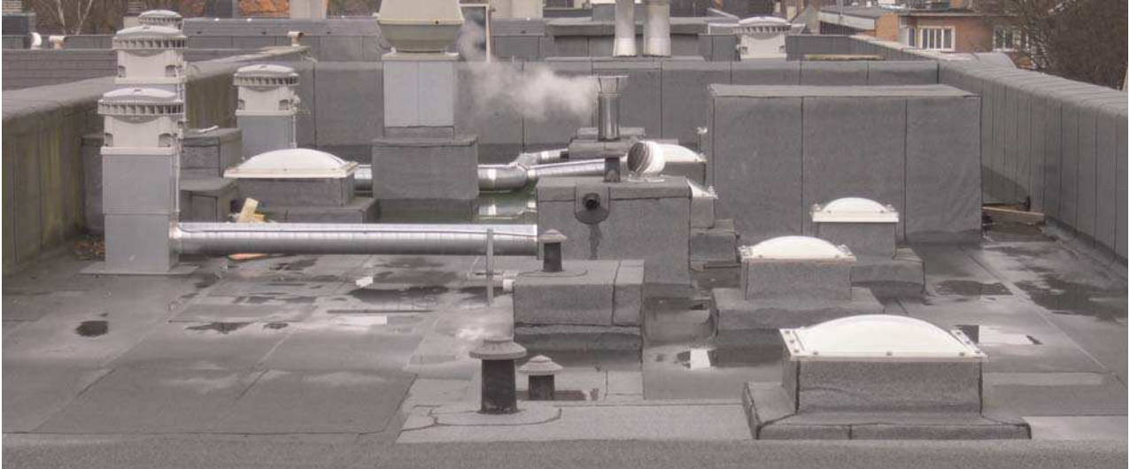
Bild 3: Völlig mit Details überfrachtete Dachfläche
