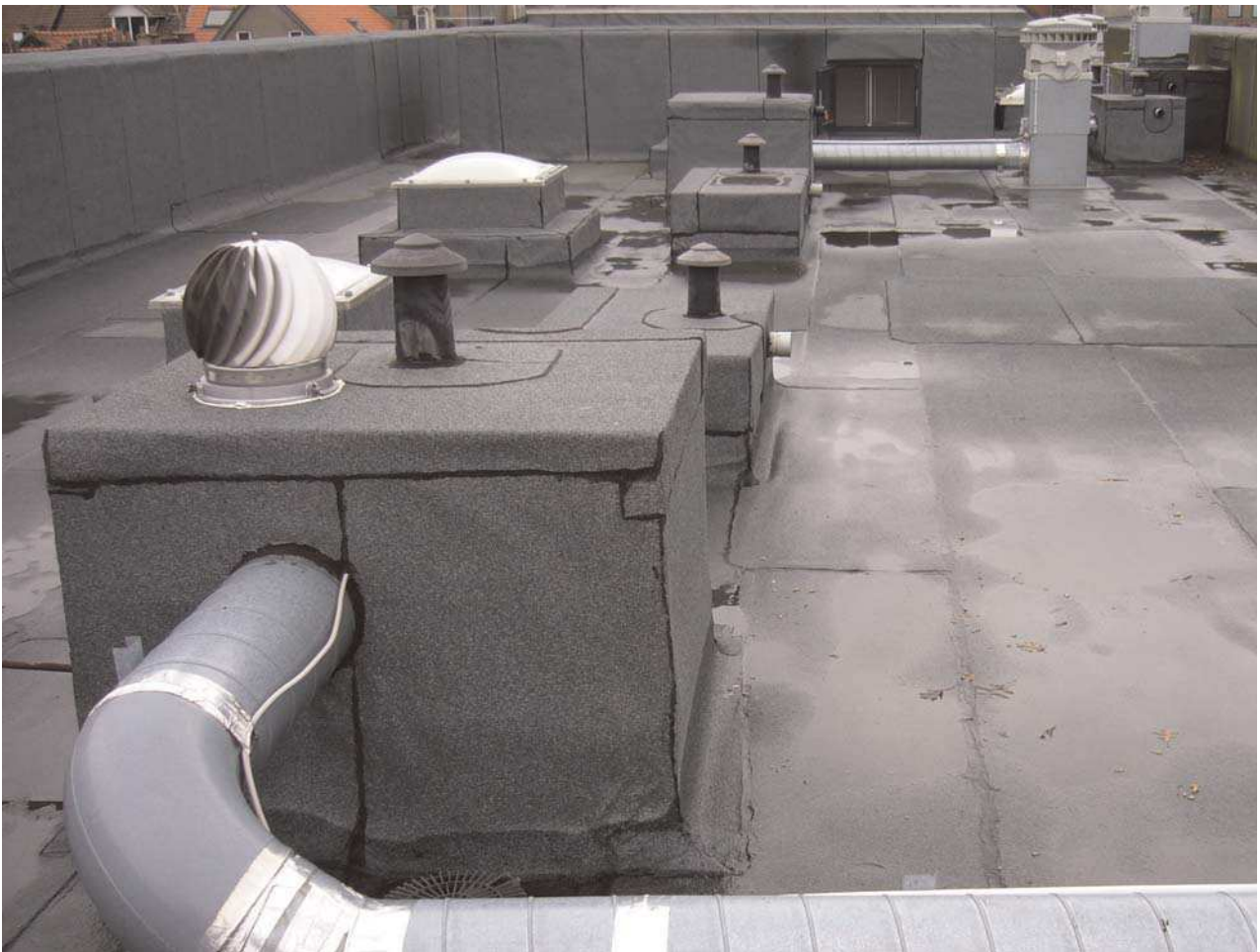
Bild 4: Wie soll der Abdichtungsfachmann solche Durchdringungen handwerklich dauerhaft ausführen?
