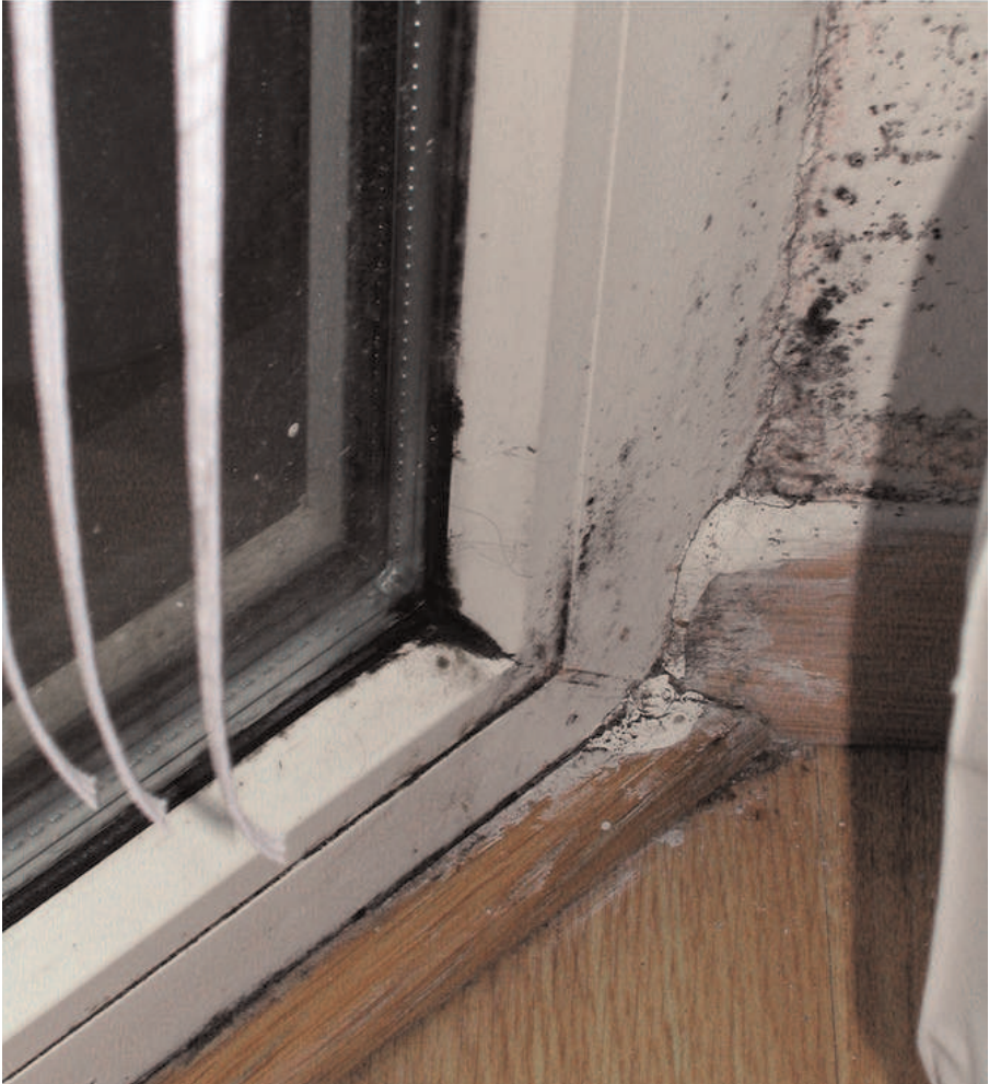
Bild 6: Schimmelfeuch am Fensterrahmen
