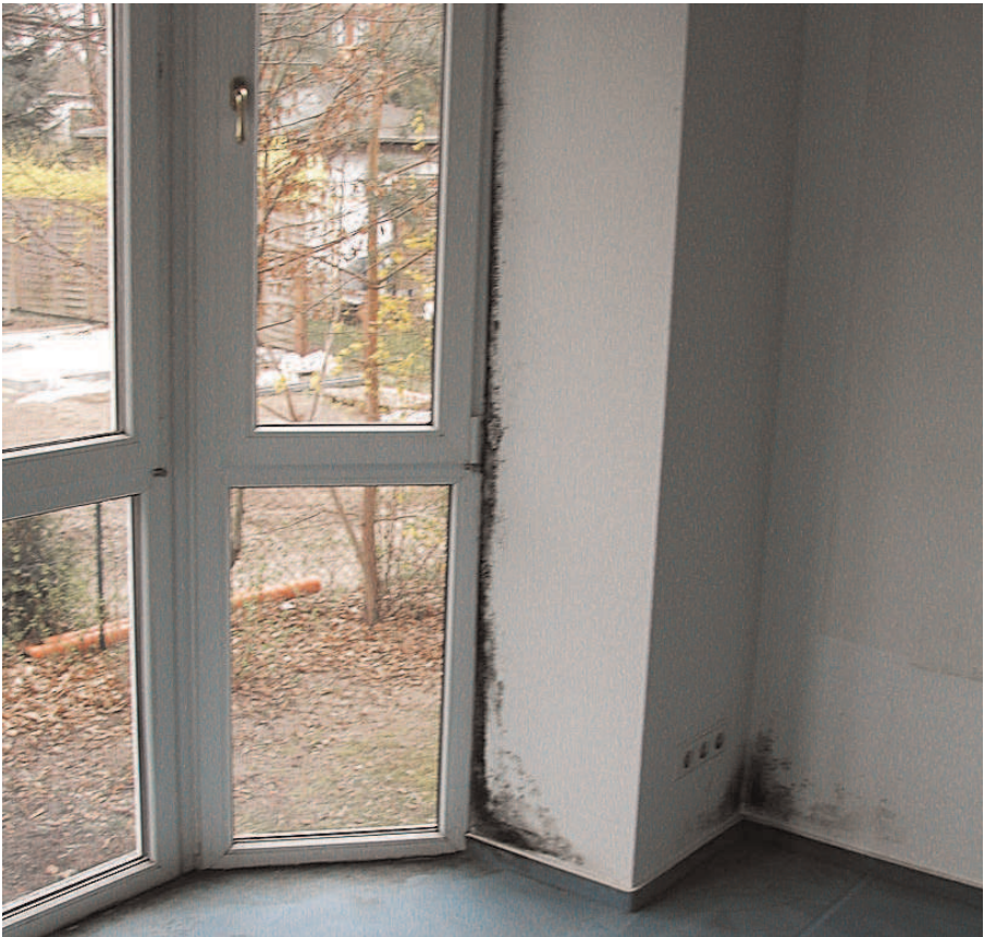
Bild 10: Schimmelbefall im Bereich von Vorhängen und Möbeln
